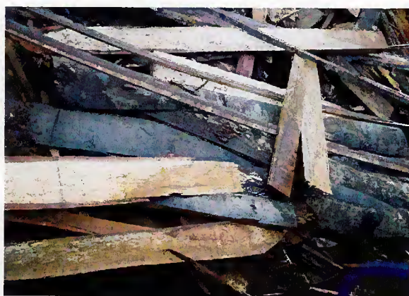
Figura 54. Finas costaneiras retiradas na Etapa I.
